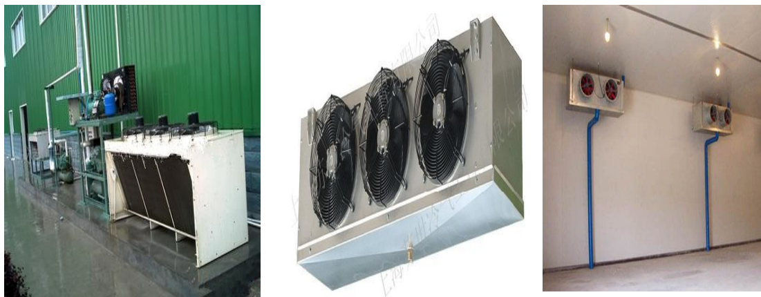
冷冻机组与冷风机
